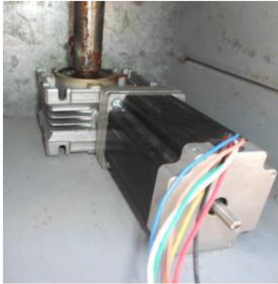
Figura N°33: Motor PaP y reductor pertenecientes al panel solar móvil. (Fuente: Elaboración propia).
