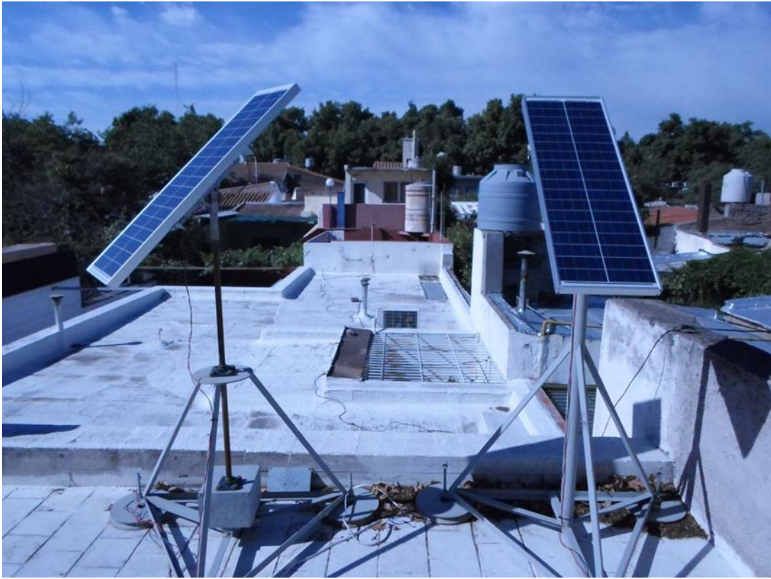
Figura N°26: Panel solar móvil (izquierda) y panel solar fijo (derecha) instalados en el techo de vivienda urbana. (Fuente: Elaboración propia).
